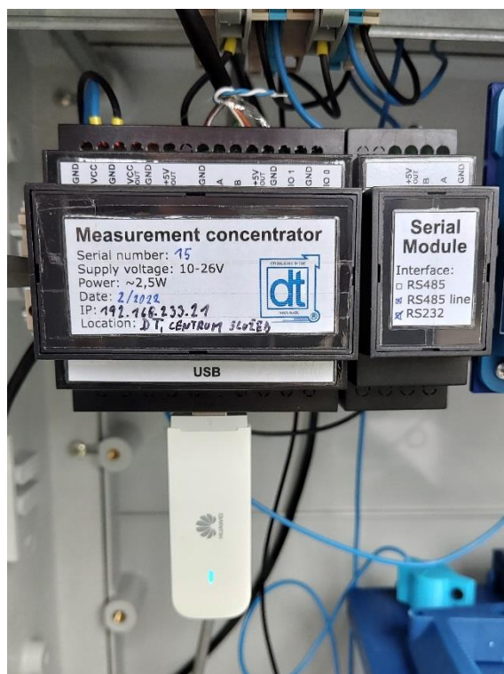
Obrázek 6: Instalace komunikačního modulu a sériového modulu v rozvaděči
